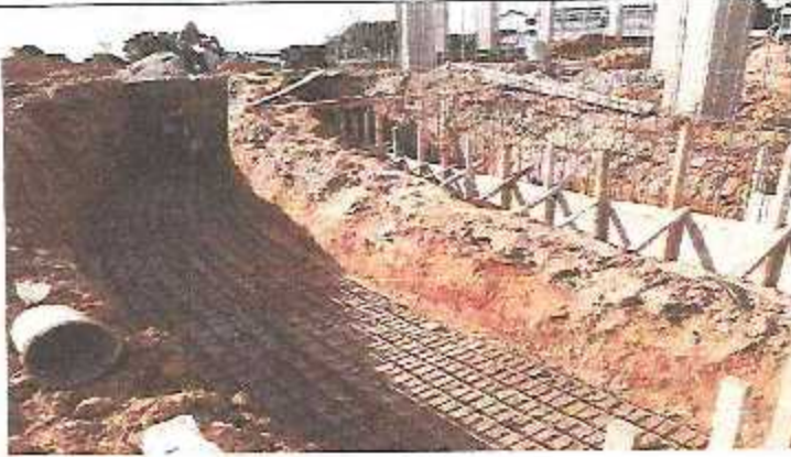
FOTO 24: COLOCACION DE ACERO EN ZAPATAS Y MURO, ENCOFRADO DE ZAPATA DE MURETES EXTERIORES
